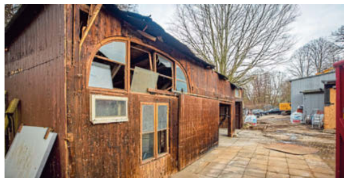
Auch eine alte Holzhütte auf dem großen Gelände hinter der ehemaligen Bäckerei muss den Neubauten bald weichen.
