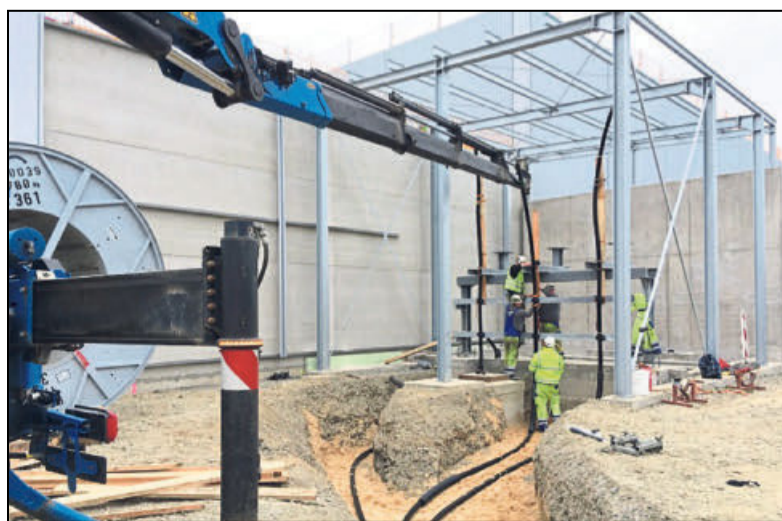
Von Berlin nach Oldentrup: Mitarbeiter des Herstellers Siemens liefern die drei Module für die Schaltanlage des neuen Umspannwerks an, das rechts zu sehen ist. Foto: Peter Offers/Stadtwerke
